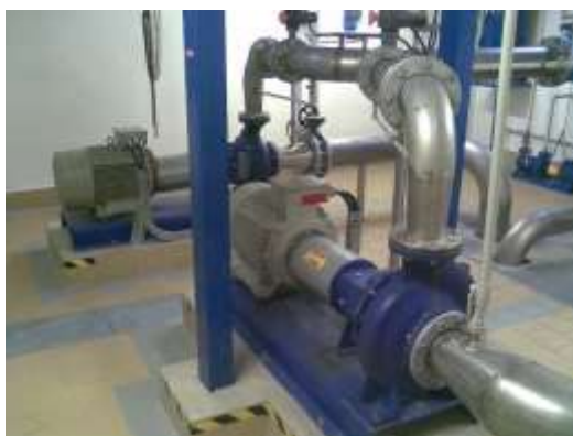
Čerpadla do sítě po výměně v roce 2011
