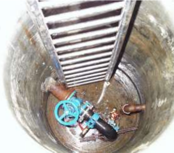
Nevyhovující provedení studny XV před demolicí - foto z r. 2003
