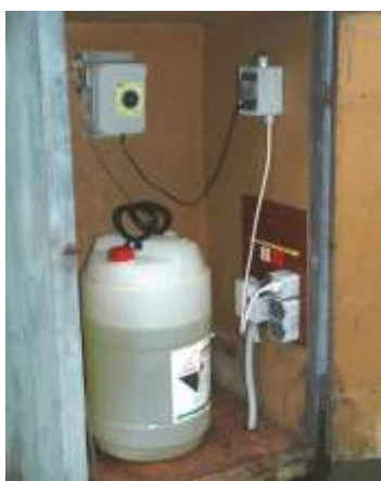
Dávkování chlornanu sodného z kiosku nad studnou č. 2 v roce 2004
