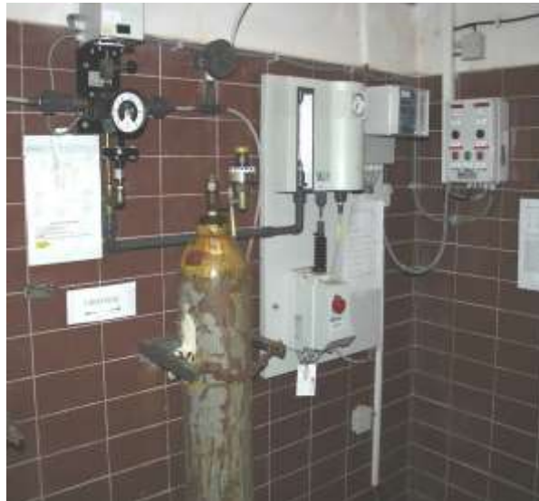
Vybavení chlorovny - foto z r. 2004
