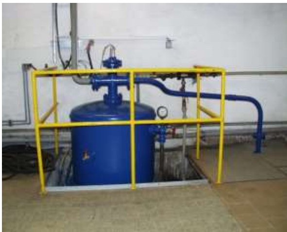
Původní strojní vybavení násoskového systému ve strojovně - foto z r. 2004
