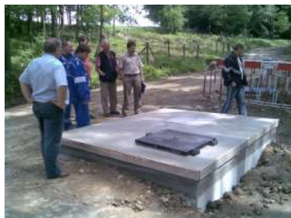
Armaturní šachta nad novou studnou XVI
