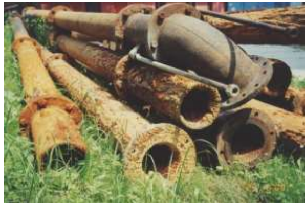
Stav potrubí ze studen po 100 letech provozu
