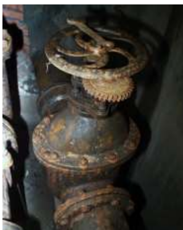
Detail původního vybavení armaturní šachty na násoskovém řadu I a II - foto z r. 2003
