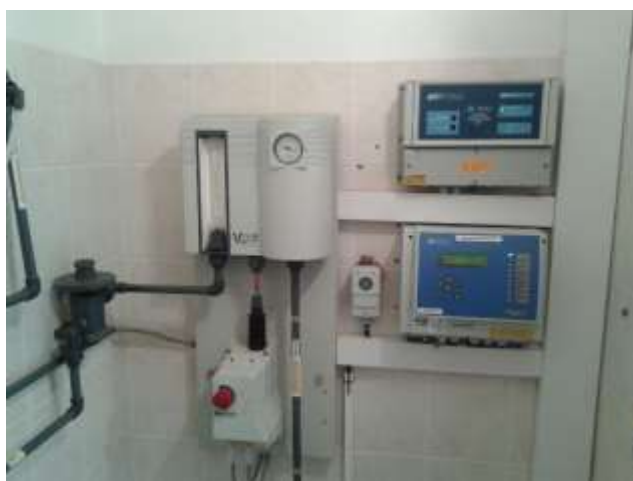
Interiér chlorovny čerpací stanice 3
