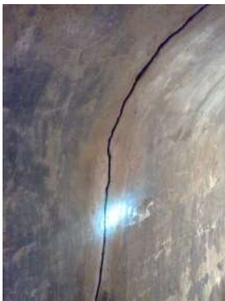
Stavební závada štoly řadu 1 – prasklina betonového zdiva
