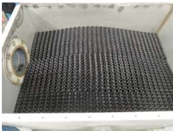
Tzv. voštiny při demontáži víka aerační věže č.3
