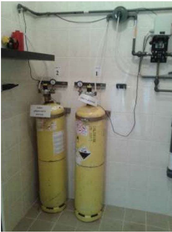
Interiér chlorovny čerpací stanice 3
