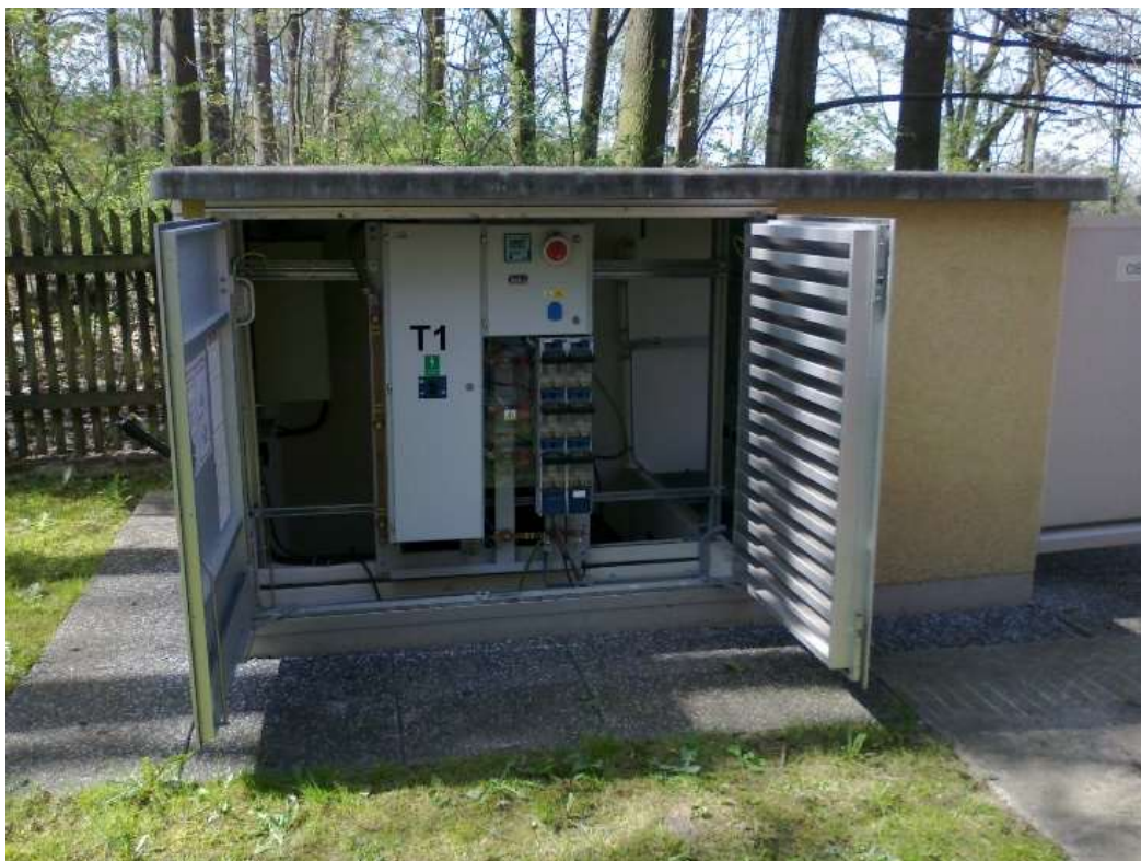
Kiosková trafostanice u čerpací stanice 2
