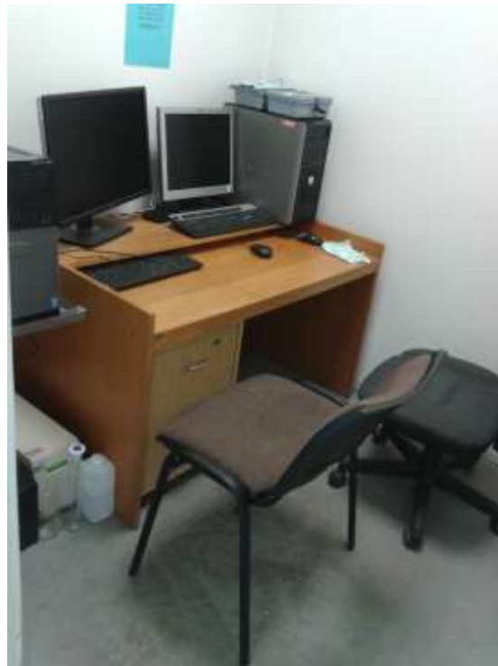
Interiér velínu čerpací stanice 3
